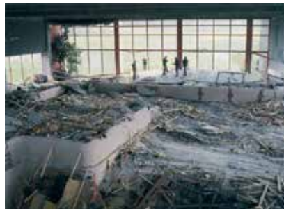
Leta 1985 je popustil betonski strop notranjega bazena v Usterju v Švici. Obese stropa iz nerjavnega jekla na zunanjo niso kazale pomanjkljivosti, na notranji strani pa so bile delno popolnoma uničene zaradi korozije, ki je posledica nateznih razpok.
